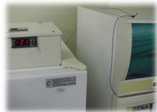
新增設之自動監控系統線路
